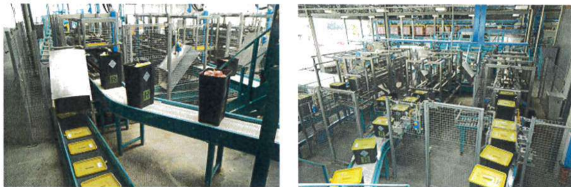
Figura 8: Sistema di movimentazione automatizzata dei contenitori
